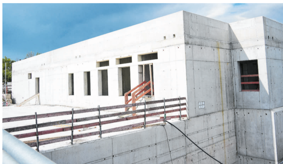
Die vorderen Öffnungen in der Wand des Betriebsgebäudes werden alles Türen sein.
